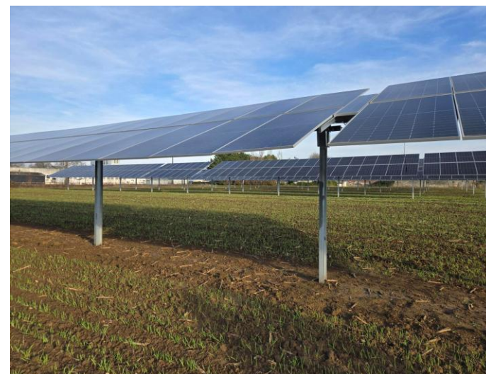
Photo de l'orge de printemps qui pousse sous les panneaux
